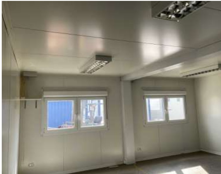
intérieur d'un module équipé d'un éclairage et de prises électriques
